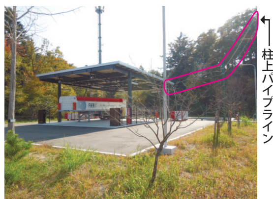
水素トレーラーから柱上パイプライン
