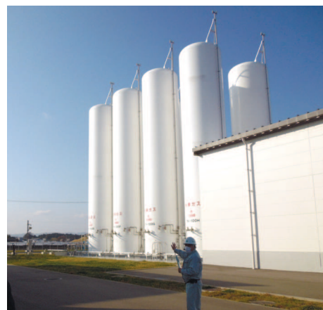
水素貯蔵・供給設備
