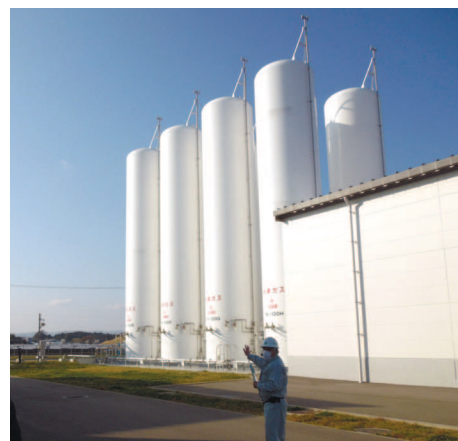
水素貯蔵・供給設備
