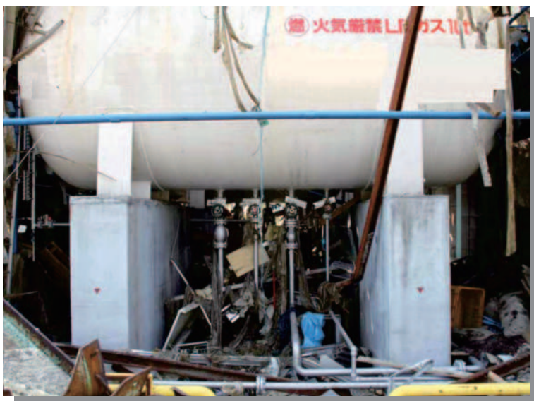
5.13 女川 被災した充填所貯槽下部
