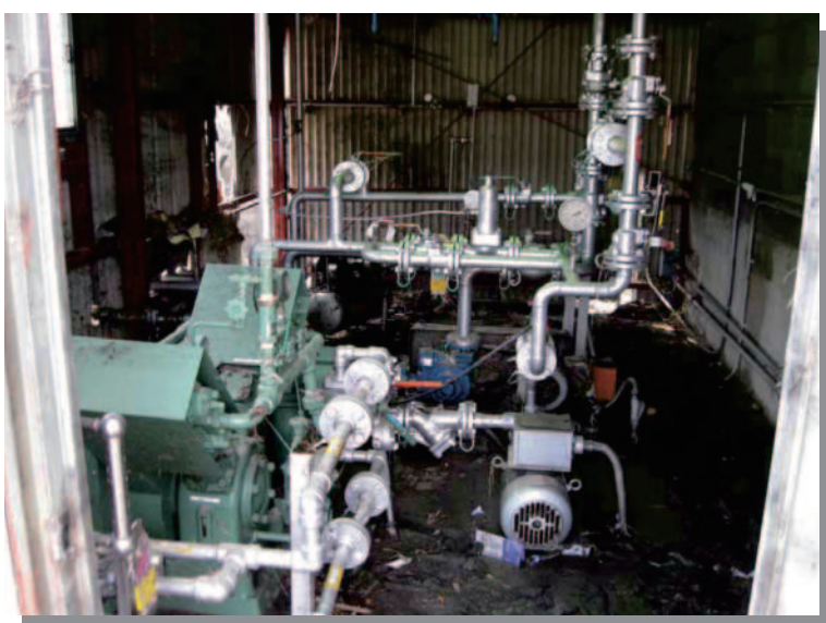
7.18 大船渡 被災したLPガス設備 (機械室)
