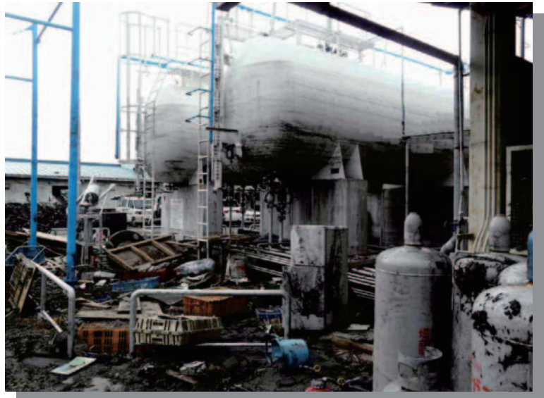
7.2 大船渡 被災した充填所
