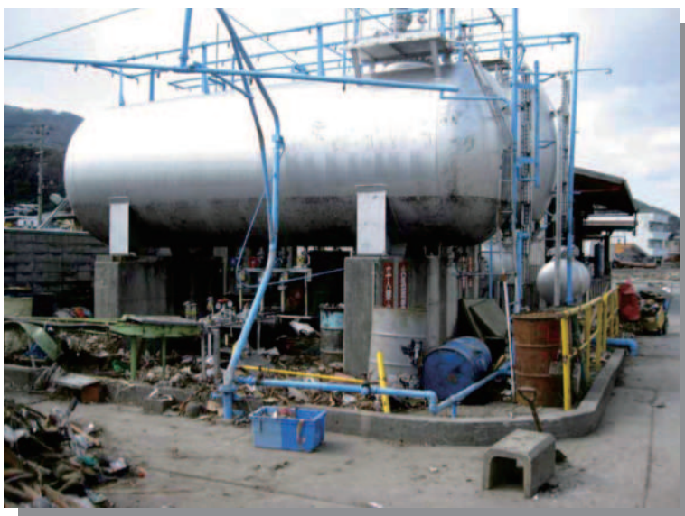
7.16 大船渡 被災したLPガス設備
