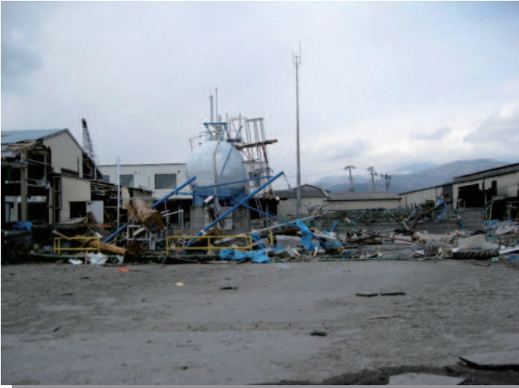
7.19 大船渡 津波により被災した充填場
