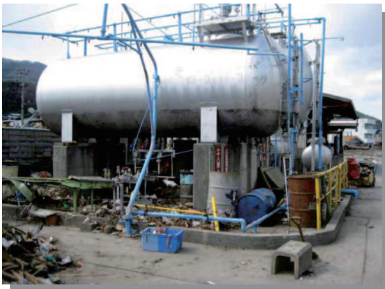
7.16 大船渡 被災したLPガス設備
