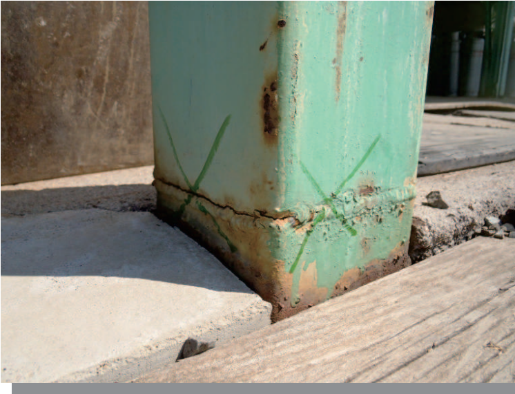
13.7 充填所支柱溶接部の亀裂
