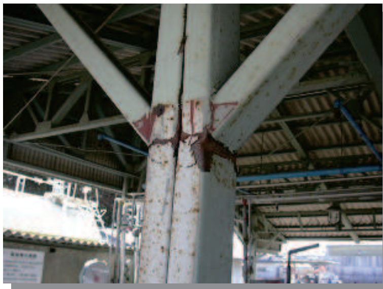
13.5 建屋柱（ライトゲージ）の破損
