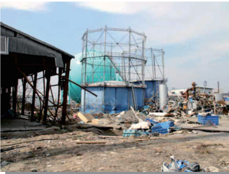
4.12 石巻 被災した都市ガス設備
