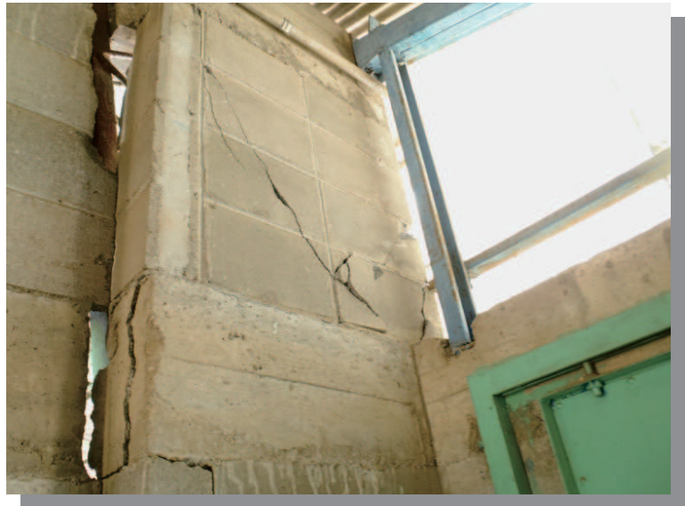
13.8 充填所機械室壁の亀裂
