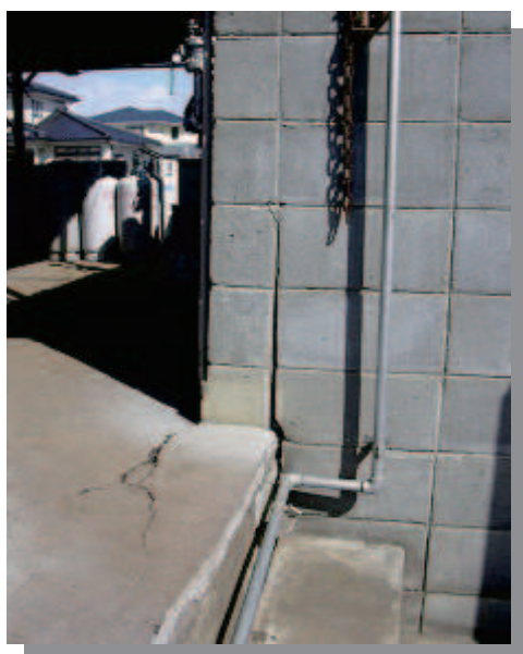
13.6 建屋の床及び壁（ブロック壁）の亀裂
