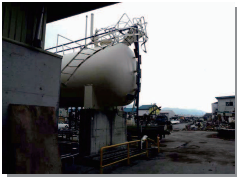
7.11 大船渡 被災した貯槽の液面計と作業用ラダー (写真7.9の流出物撤去後)
