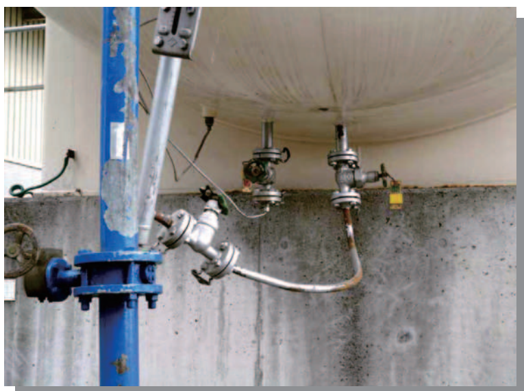
7.12 大船渡 ダメージを受けた貯槽元ノズルと液面計用配管
