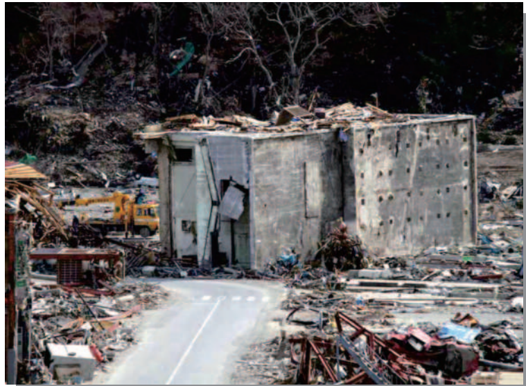
5.5 女川 転倒したビル (左側が基礎部分)
