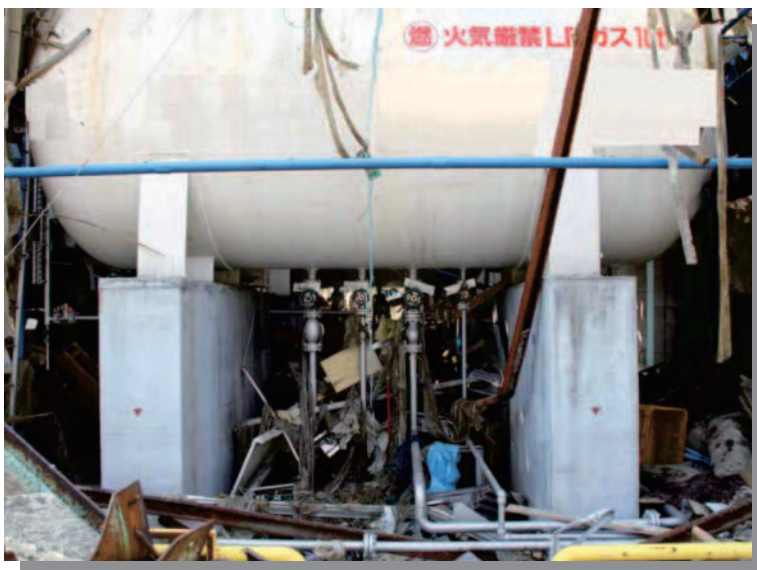
5.13 女川 被災した充填所貯槽下部
