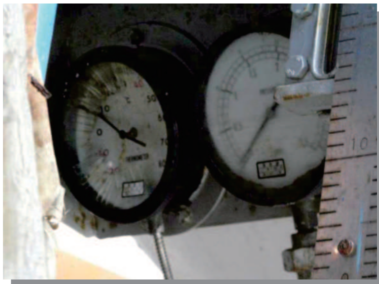
5.14 女川 被災した充填所，貯槽の圧力計 (内圧は0を示している。)
