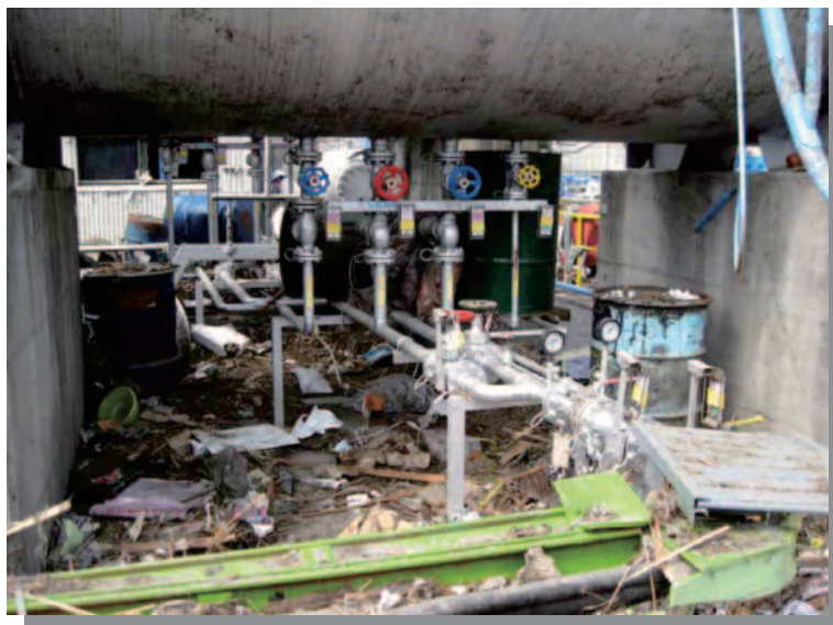
7.17 大船渡 被災したLPガス設備 (貯槽下配管設備)
