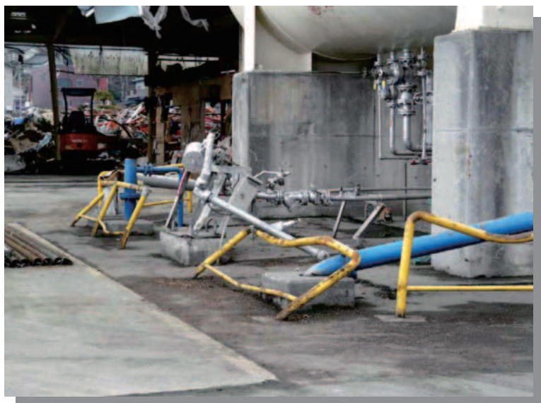
7.10 大船渡 被災した充てん場受入れ設備 (写真7.9の流出物撤去後)
