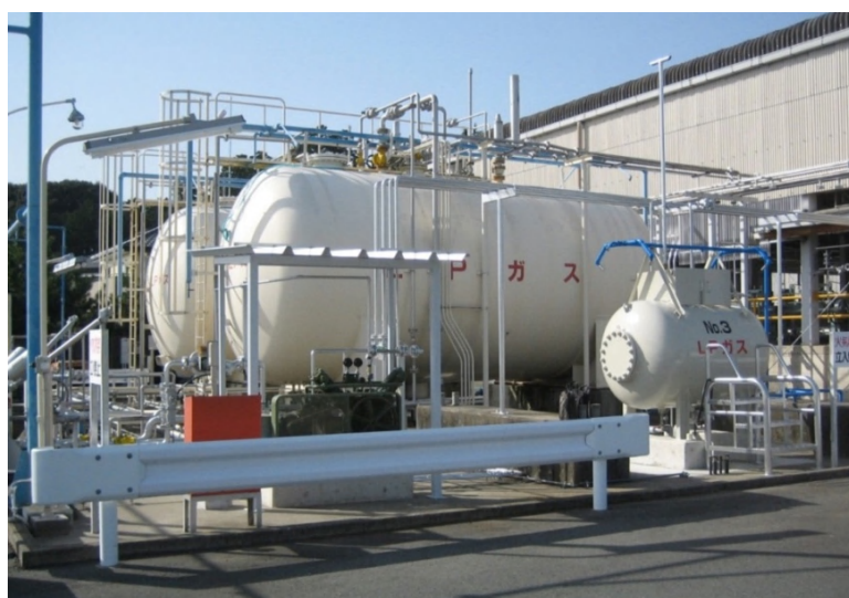
残ガス回収貯槽による残ガス回収
